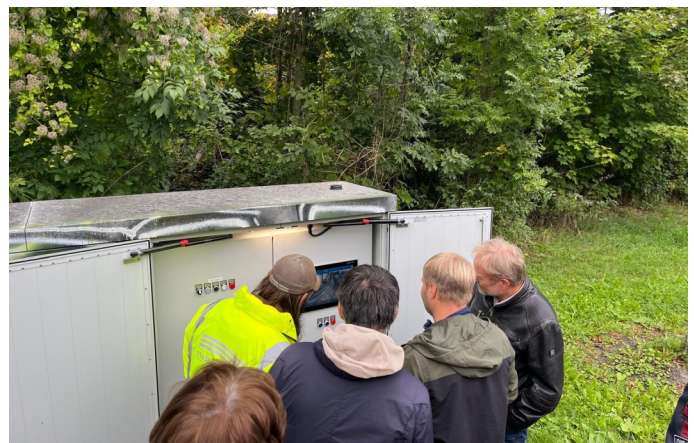
Abbildung 17: Teilnehmer:innen bei Schaltschrank in der Live-Demonstration am Bauwerk RÜ 09 (Quelle: HST Systemtechnik GmbH & Co. KG)
