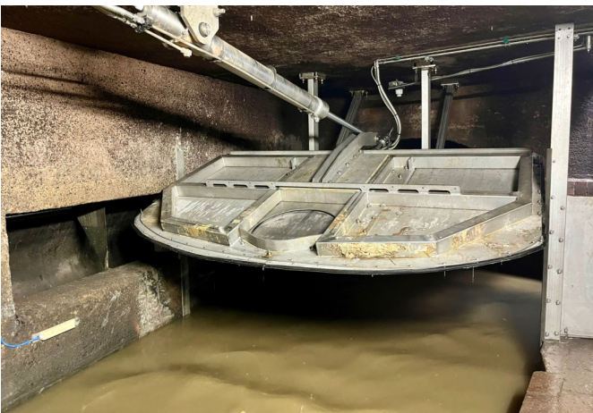
Abbildung 16: Im Kanal installierte Verschlussklappen regulieren den Schmutzwasserstrom (Quelle: Stadtwerke Jena)
